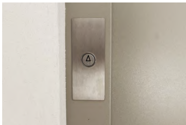
Botonera exterior de la cabina.
